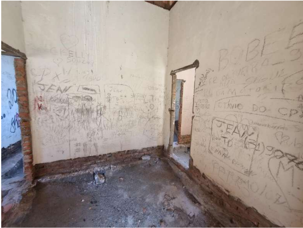
Imagem 16 - Interior da Estação deteriorado/pichações
